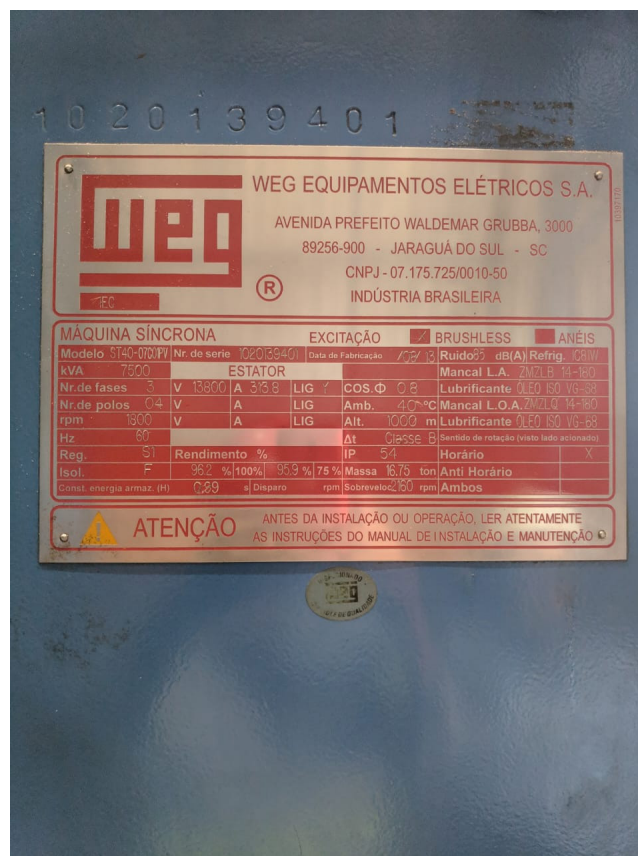
Alternator/ Generator nº 1 – UTE 01
